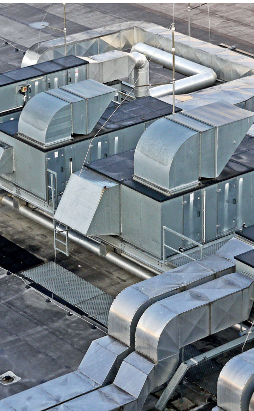
Klimaanlagen zum Schutz bei Hitze teils notwendig
