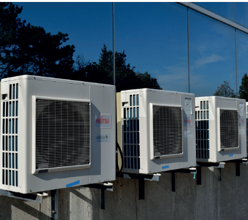
Klimaanlagen zur Gebäudekühlung sollten nur in Ausnahmefällen genutzt werden
