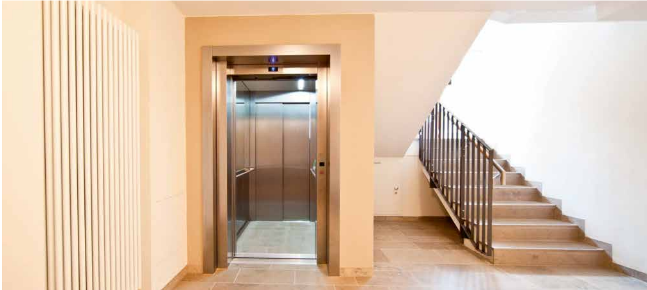
Aufzug in historischer Bausubstanz Reichenberg, Seniorenwohnhof am Schlossberg
